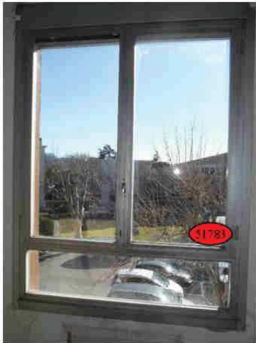
Mastic vitrier 1 contenant de l'amiante présent dans l'escalier, au 1 er étage (échantillon 51783).
