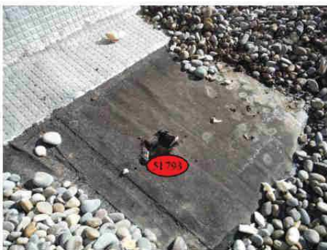
Complexe d'étanchéité multicouche contenant de l'amiante présent en toiture terrasse au dessus du RDC (échantillon 51793).
